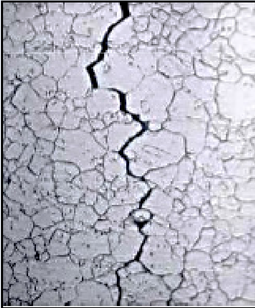
Corrosão sob tensão de tubo de Inconel em um trocador de calor Fratura intergranular
